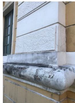
Cimalha da Fachada Principal
